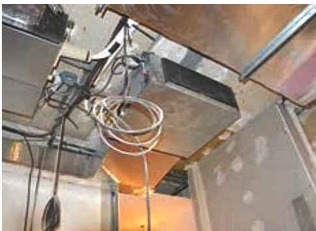
▲ L'intérieur du bâtiment a été équipé de 23 unités intérieures dont 14 gainables installés dans les plenums.
